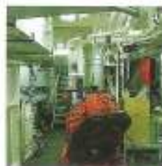
engine room phòng máy 轮机舱 lúnjīcāng
